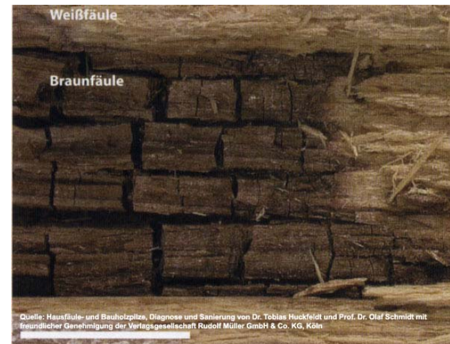
Abb. 2.11: Braun- und Weißfäule an einem Holzstück aus einem Dachboden: links Braunfäule mit Würfelbruch (Echter Hausschwamm) und deutlich dunklerer Farbe als die Weißfäule rechts (Ausgebreiteter Hausporling); Maßstab 1 cm
